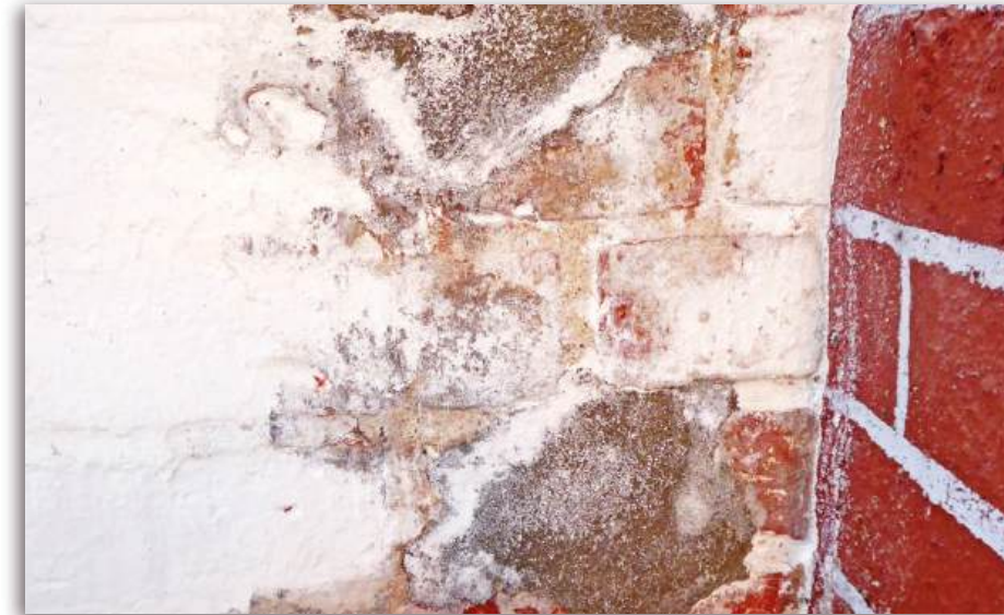
Nördliches Querhaus, Salzausblühungen im Umfeld von Zementputzungen
